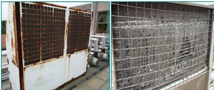
圖 2.3.10 設備外觀鏽蝕與鰭片破損情形
