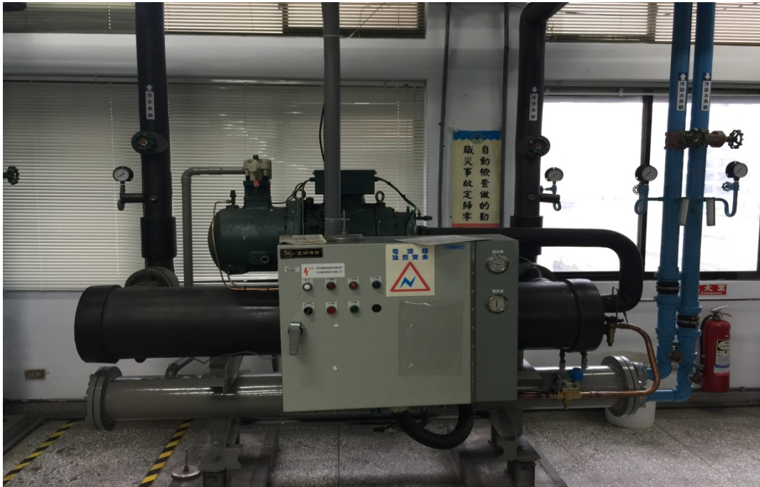
圖 2.1.12 中央空調冰水主機（螺旋式 40RT）
