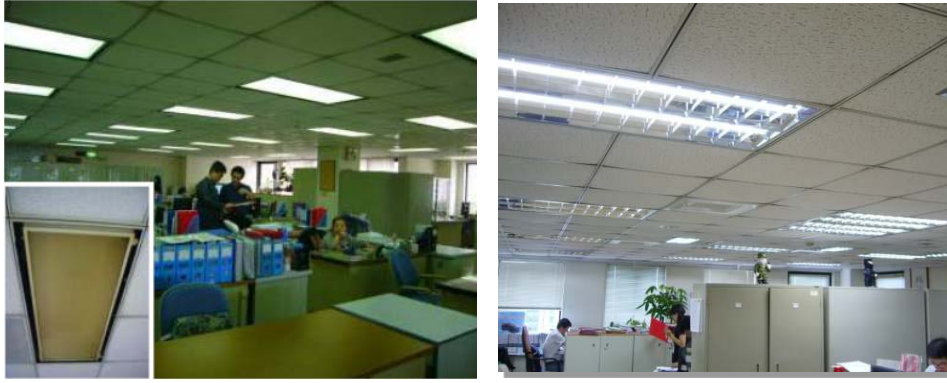
圖 5.2.26 內政部移民署改善老舊燈罩實例 48
