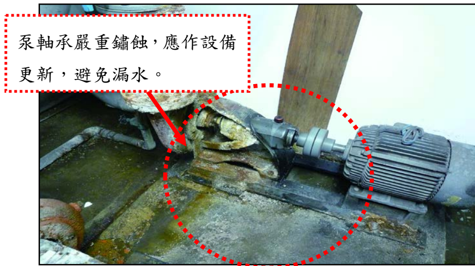
圖 2.3.3 水泵浦軸承鏽蝕漏水
