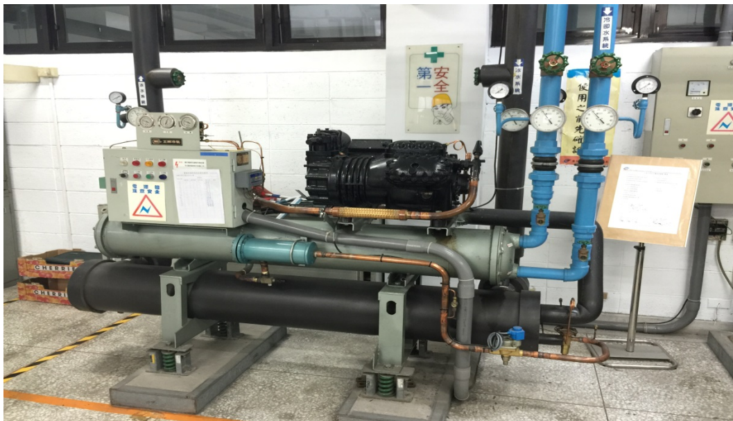
圖 2.1.13 中央空調冰水主機（往複式 40RT）
