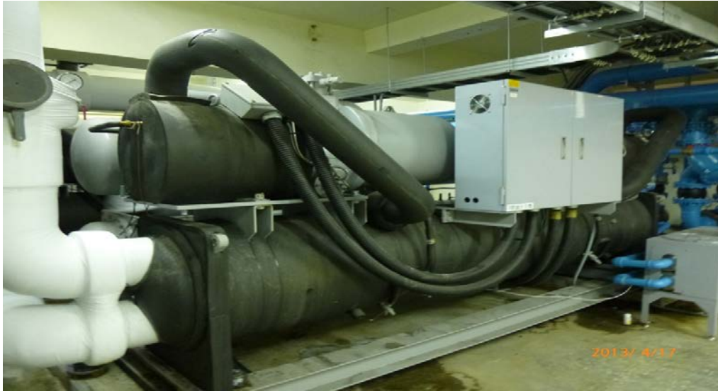
圖 2.2.3 儲冰式冰水主機
