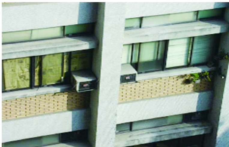
圖 2.3.11 室外機安裝位置錯誤
