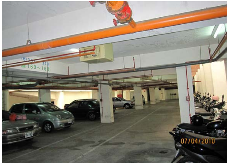
圖 5.2.15 地下停車場設置光井引入自然光減少燈具開啟
