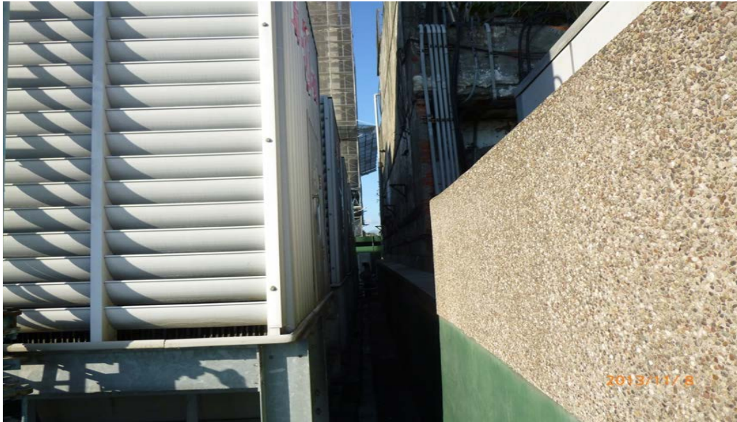
圖 2.3.8 冷卻水塔設置過於靠近牆面
