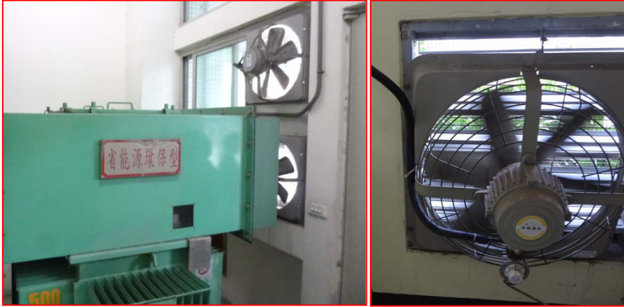
圖 4.2.4 高壓變電室設置排風扇並搭配溫控開關
