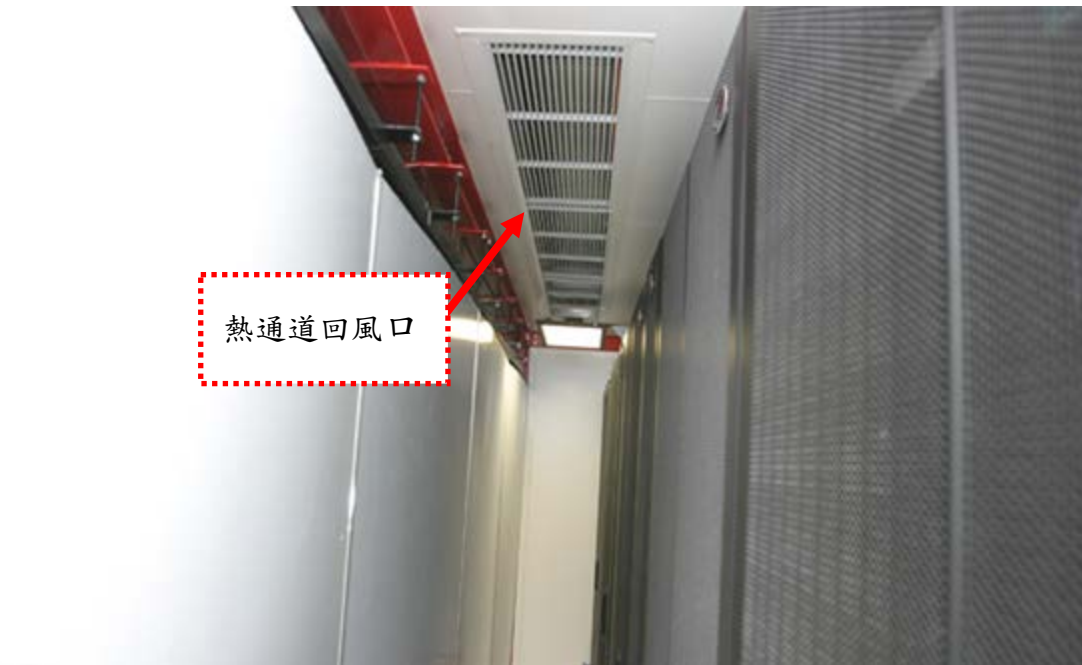
圖 2.2.8 電腦機房熱通道 15
