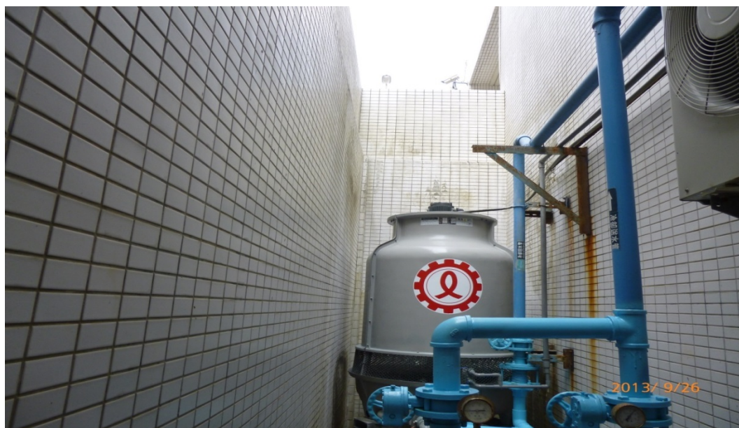
圖 2.3.7 冷卻水塔散熱不良
