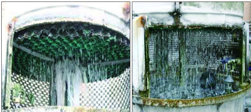
圖 2.3.9 冷卻水塔灑水不均(左圖)與正常情況(右圖)之對照
